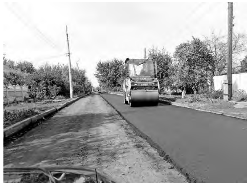
В августе начались работы по восстановлению дорожного покрытия на улице Свободы, в поселке Торецкий
